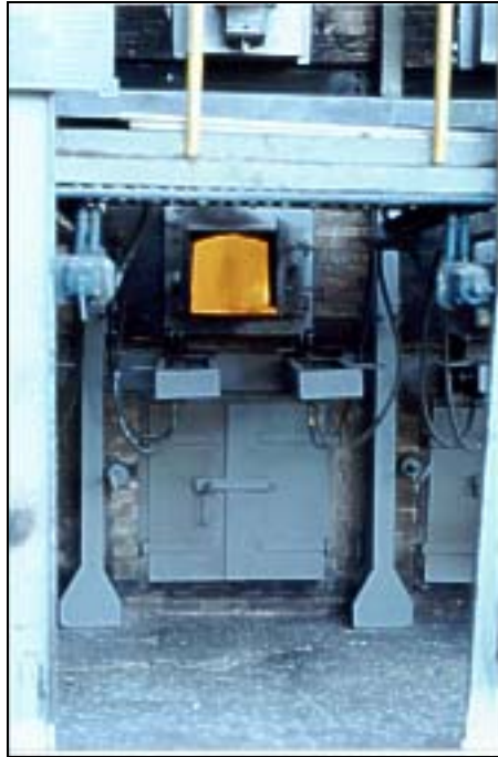
Figura 10 - Caldeira de combustão do bagaço
