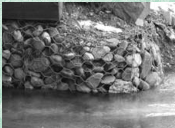
Figura 80 - Cestas de arame, também chamadas de gabiões, são outra estrutura de contenção.
