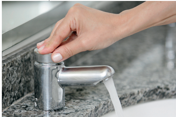
FIGURA 28 – TORNEIRA COM FECHAMENTO AUTOMÁTICO: ECONOMIA DE ÁGUA.
