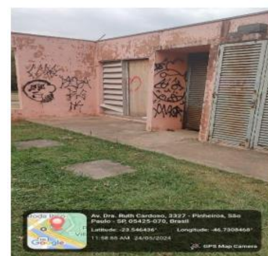
Paredes externas dos sanitários estão danificadas (pichadas, com revestimentos quebrados e aspecto de abandono).
