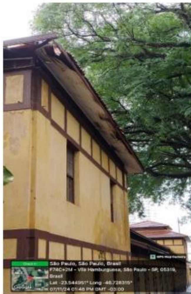
Prédio 10 – Pavilhão para Equinos. Telhado e beiral em condições precárias de conservação
