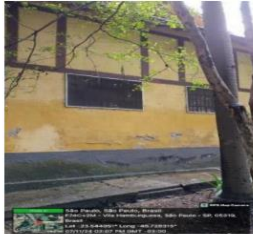
Pintura com sinais de infiltração
