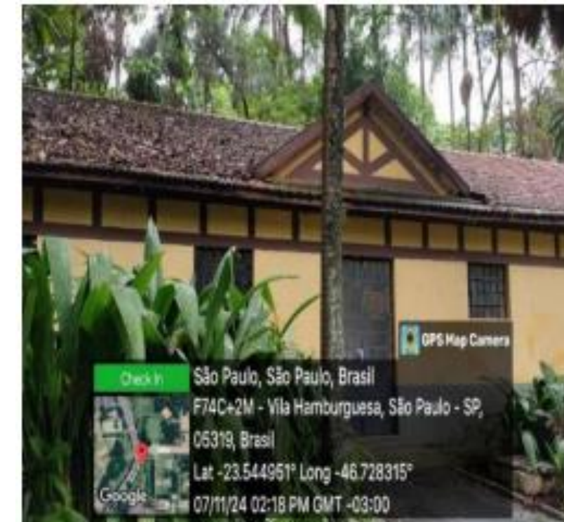
Acúmulo de sujeira no telhado
