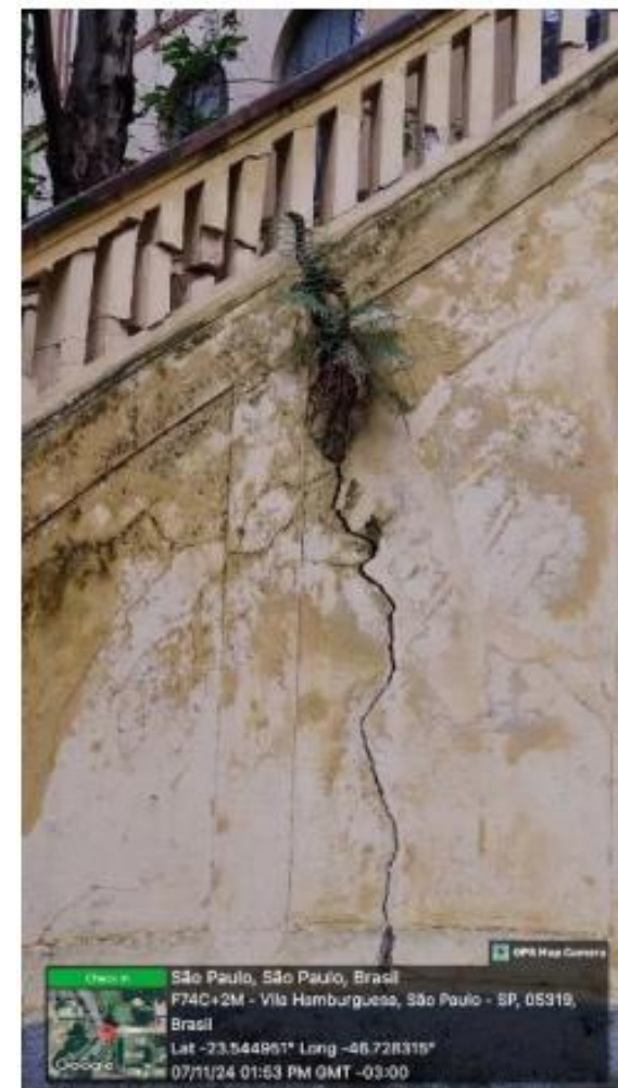
Prédio 23 - Prédio do Fazendeiro. Sinais de infiltrações e rachadura
