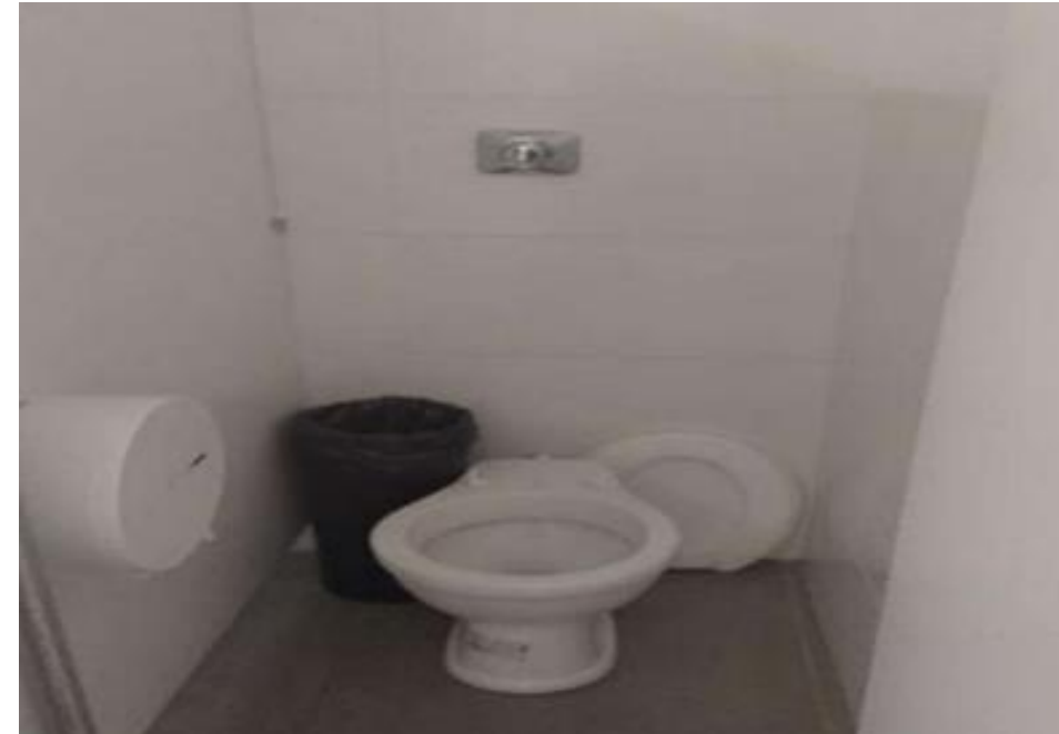
Banheiro sem a tampa do vaso
