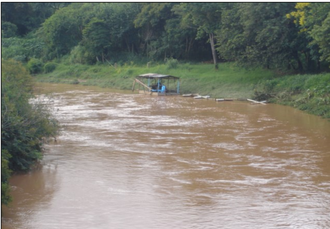
Foto 48 - Sistema de dragagem de areia (montagem em barcaça semi-móvel) no leito do rio Jundiáí (Edson Farinha).
