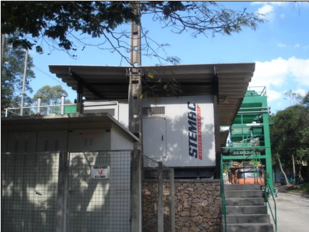
Foto 11 - Instalações da usina de fabricação de asfalto (Pedreira Tavares Pinheiro).
