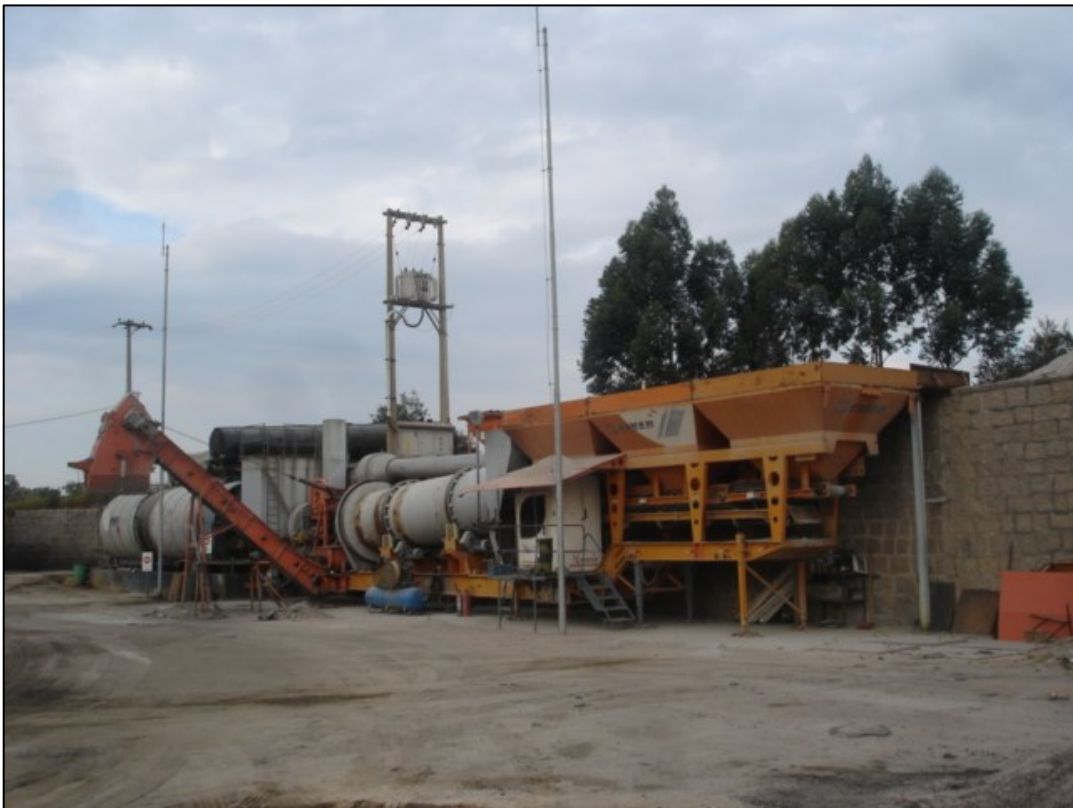
Foto 28 - Instalações de usina de fabricação de asfalto (Pedreira Pinhal).
