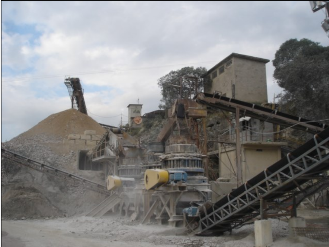
Foto 27 - Vista geral das instalações de beneficiamento da brita (Pedreira Pinhal).
