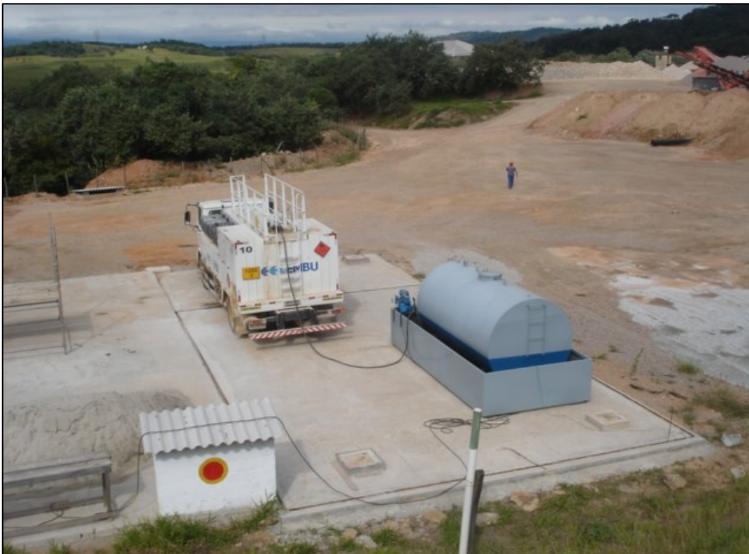
Foto 21 - Vista geral da área operacional a ser utilizada para novas instalações previstas (aquisição de unidades fixas) no sistema de beneficiamento da brita (Pedreira Embu).
