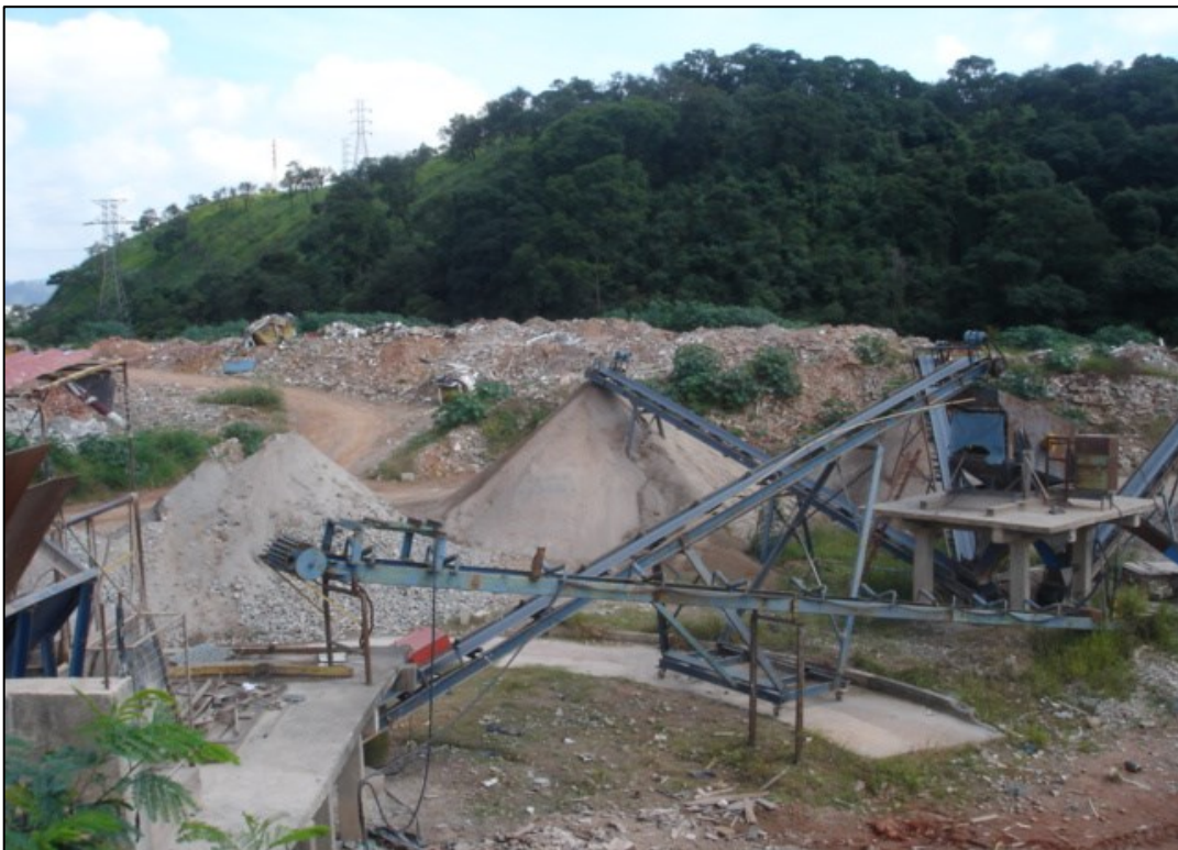
Foto 58 - Instalações atuais de reciclagem de entulho da RMP, com pilhas de material de bota-fora ao fundo (Samaronne).
