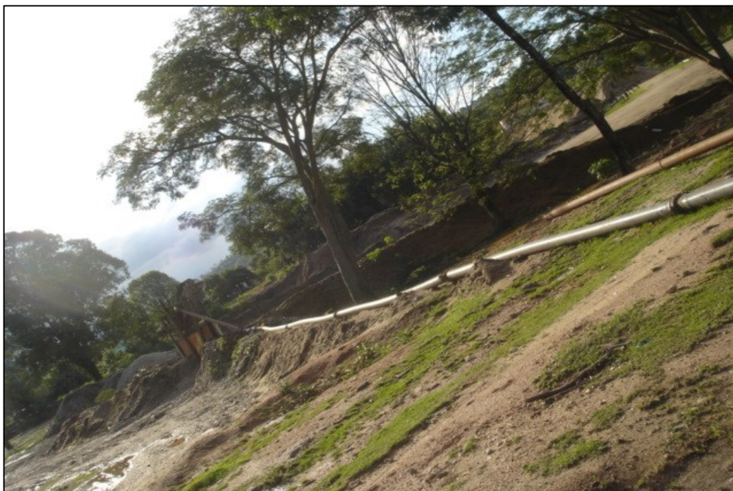
Foto 55 - Linha de tubulação para transferência de polpa de areia por bombeamento com sistema de classificação por peneiramento estático ao fundo (Gouvea Comércio de Areia).
