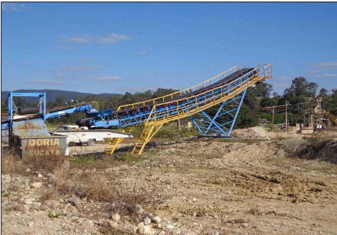
Foto 34 - Instalações novas adquiridas para operações de reciclagem de entulhos da construção civil (Itabrás Mineração).
