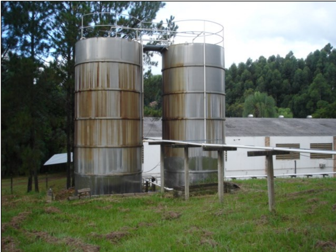
Foto 105 - Tanques em aço inoxidável para armazenamento de água mineral proveniente das fontes (Hidra Mineração).
