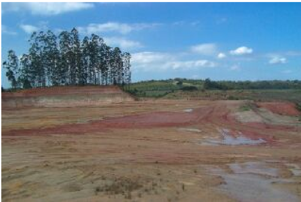
Foto 11 – Vista geral da área pós-mineração que está sendo preparada para novo uso com fins industriais (Porto 7 da Mineração Itaquareia).
