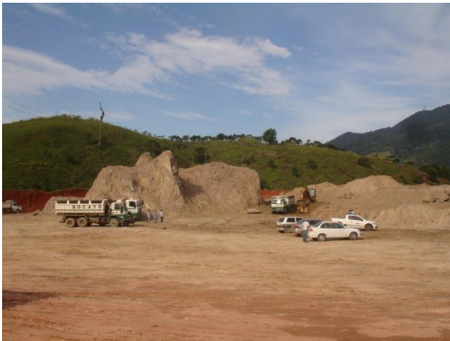
Foto 7– Barreira Pegorelli – SS. Nunes Terraplanagem em Caraguatatuba (LN – 06): observar núcleo de rocha granitoide remanescente em mina de saibro.
