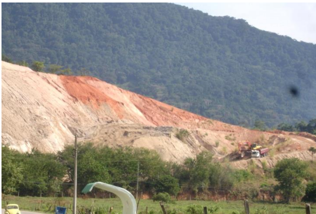
Foto 5 - Mineração Ideal Terraplanagem – São Sebastião (LN – 05): ao fundo frente de lavra com produção de saibro.
