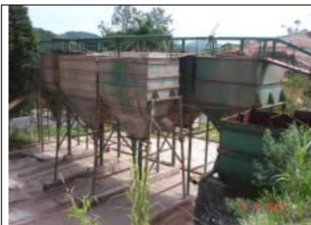
Foto 7 - Silos de armazenagem de areia em área de expedição do produto (Extratora Verava).
