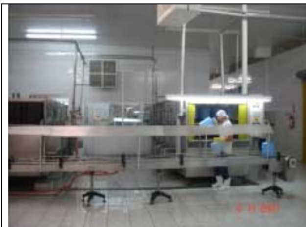
Foto 13 - Equipamentos utilizados para a limpeza de garrafões e envasamento de água (Mineração Águas de Ibiúna).
