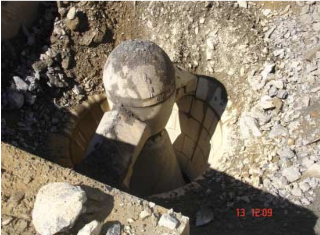
Foto 9 - Entrada do britador primário - Pedreira Khouri/Lafarge.
