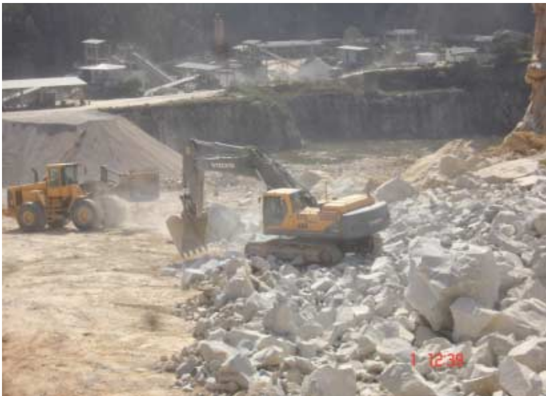
Foto 30 - Área de operação onde ocorreu desmonte rochoso recente - Pedreira Anhanguera.
