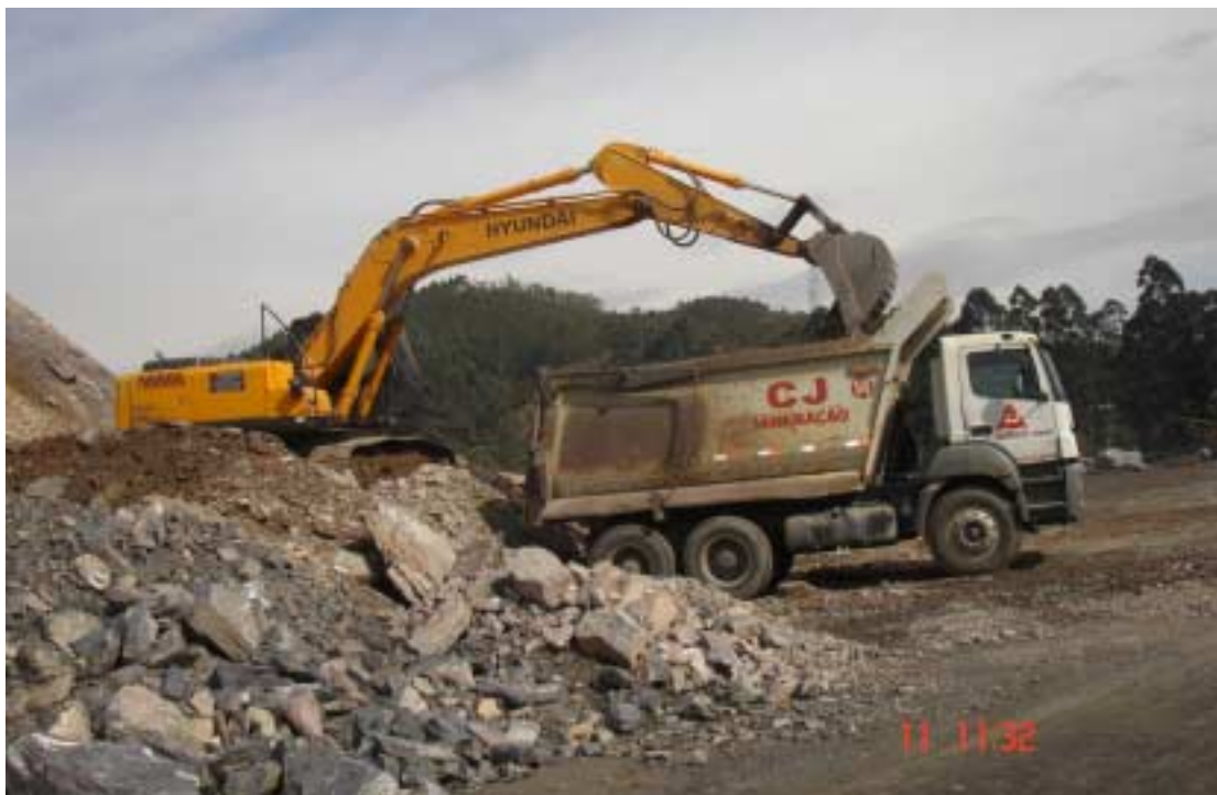
Foto 20 – Carregamento a partir de pilha de estocagem de material para produção de bica corrida - Pedreira CJ / Votorantim.
