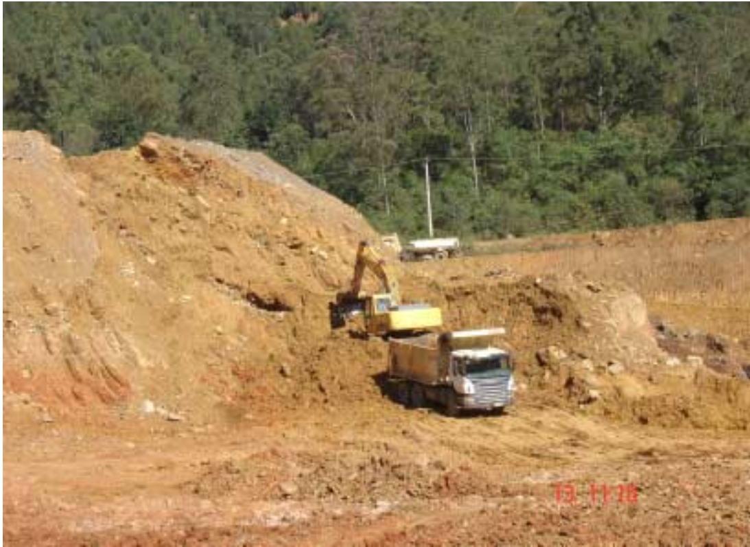
Foto 7 - Operação de carregamento de caminhão com material estéril para transporte até área de disposição - Pedreira Khouri/Lafarge.
