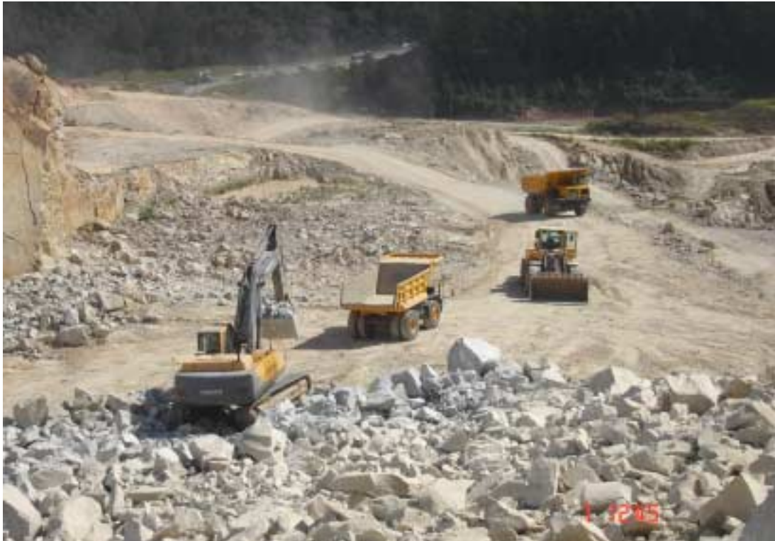
Foto 31 - Movimentação de máquinas em local onde ocorreu desmonte rochoso recente - Pedreira Anhanguera.
