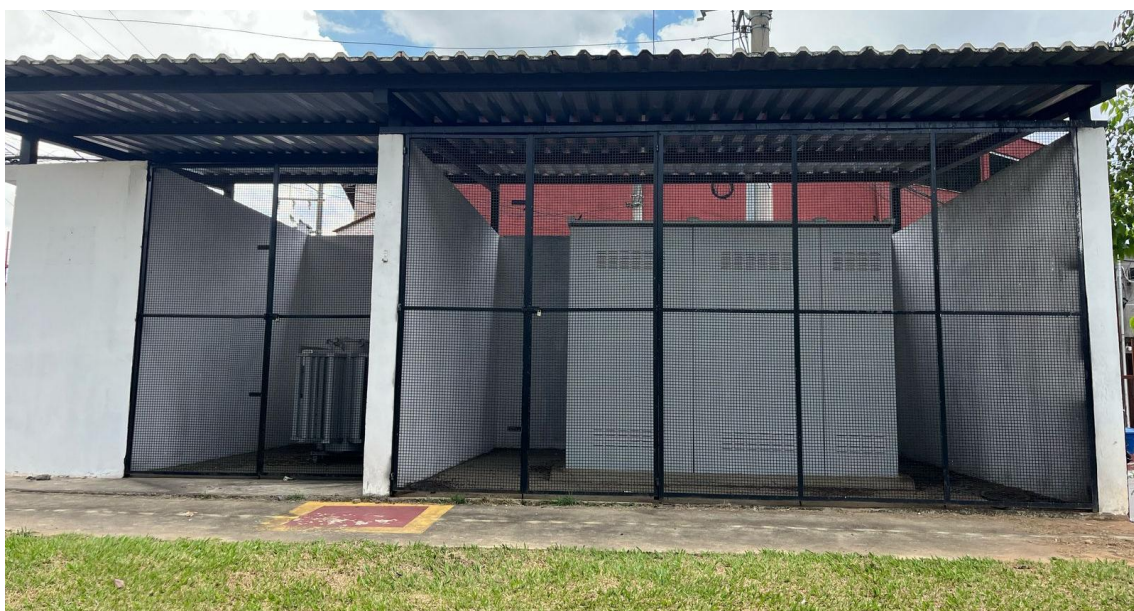
Figura 93. Cabine de energia do Núcleo de Lazer Maria Cristina Hellmeister de Abreu. Fonte: Diretoria de Parques Urbanos, 2025.
