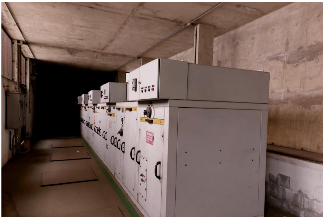
Figura 93. Cabines de energia primária. Fonte: Coordenadoria de Parques e Parcerias, 2023.
