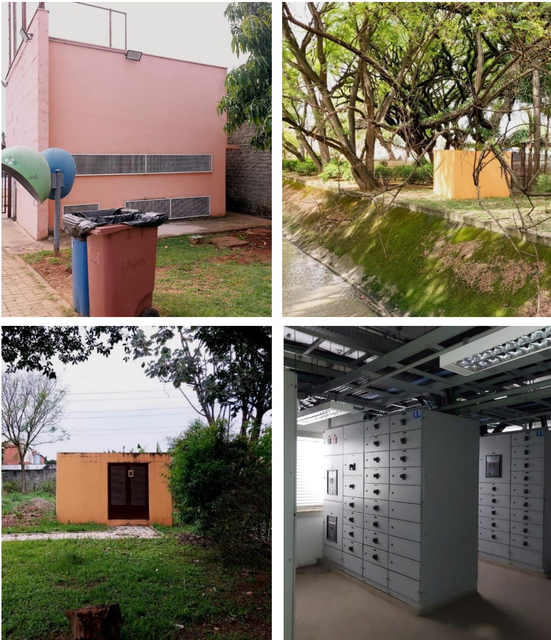
Figura 92. Cabines de energia secundária (Do canto superior esquerdo localizada na portaria da Avenida Zaki Narchi, do canto superior direito na Avenida Ataliba Leonel, do canto inferior esquerdo localizado próximo da administração e do canto inferior direito na área interna do restaurante). Fonte: Coordenadoria de Parques e Parcerias, 2023.
