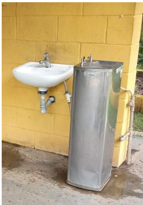
Imagem 65 - Bebedouro em inox apoiado no chão (c).
