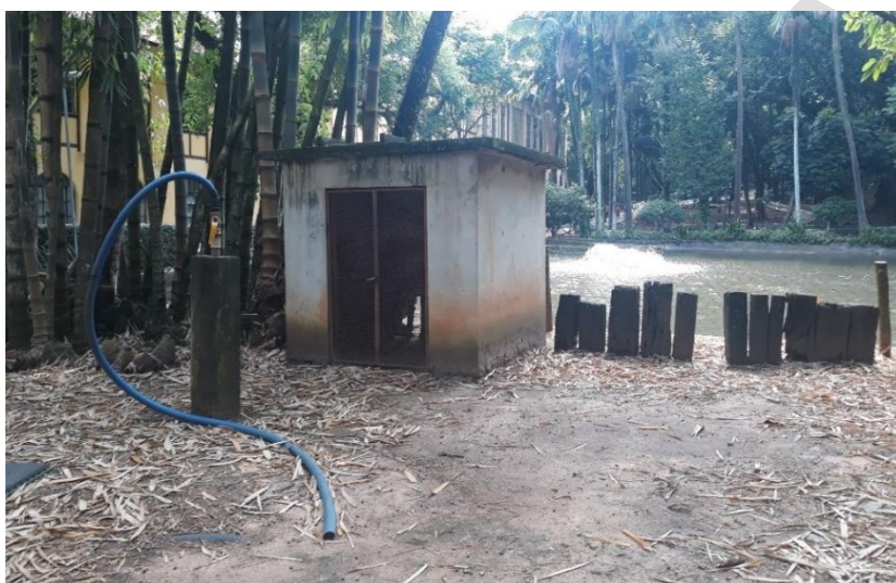
Imagem nº 48. Captação de água no Lago Preto. Fonte: Coordenadoria de Parques e Parcerias – SIMA/SP, 2020.
