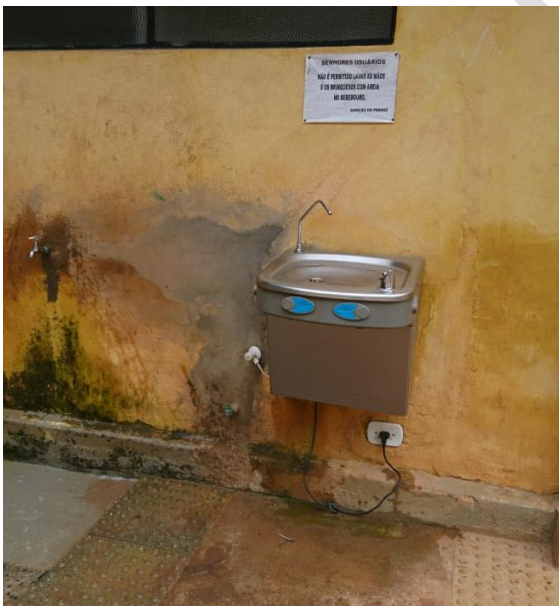
Imagem nº 59. Bebedouro modelo d) suspenso na parede do sanitário do playground. Fonte: Coordenadoria de Parques e Parcerias – SIMA/SP, 2020.
