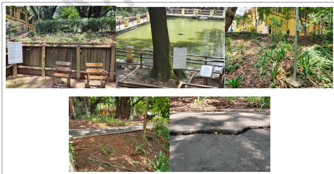
Imagem nº 10. Praça do Idoso com represa; áreas com declive e abatimento do terreno; detalhe do desnível na via asfaltada; e, trabalho para a contenção em um dos lados.
