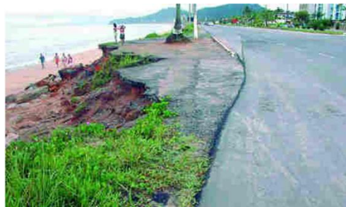
Figura 33 Erosão na praia de Massaguaçu, Caraguatatuba. Fonte: www.ecolnews.com.br
