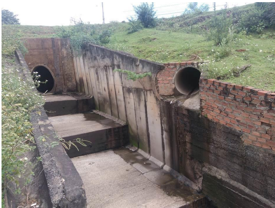
Apêndice 2.2.6.1.J. Canalização a céu aberto do córrego da Piedade e duto de água pluviais (à direita) (ponto 1).
