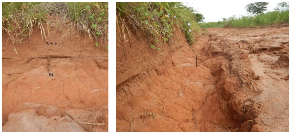
Apêndice 2.2.3.Q. Feição erosiva no entorno da FENP em área de ocorrência do Argissolo, evidenciando a diferença de estrutura ao longo do perfil.
