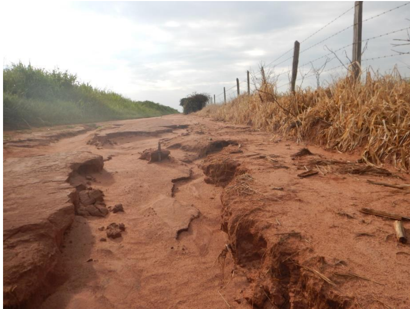
Apêndice 2.2.3.P. Feição erosiva no limite da FENP em área de transição do Latossolo para o Argissolo.
