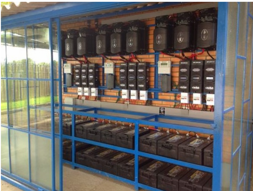
Foto 2 – Banco de baterias fotovoltaicas
