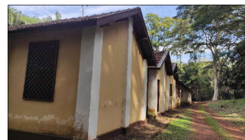
Outros pontos de danos na pintura externa somados aos detacamentos que são as sujidades ocasionadas pelo beiral curto que permite o retorno das águas pluviais no barrado da edificação.
