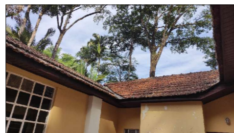
Danos causados na cobertura em razão de movimentações das peças com vento, contatos de animais e quedas de galhos, ocasionando pontos de infiltração na edificação.
