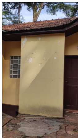
Danos em alguns pontos dos pisos de entornos da edificação do museu.
