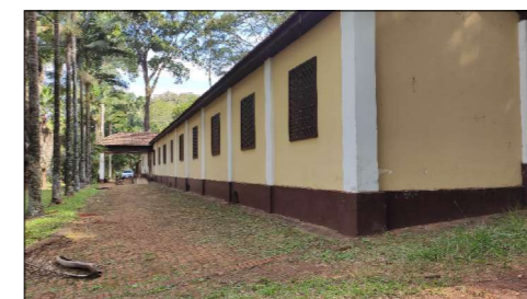
Crescimento de vegetação nos pisos externos causando algumas movimentações dos materiais.
