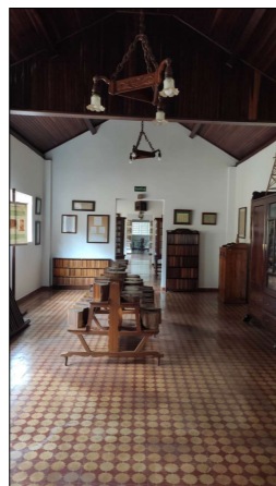
Danos em alguns pontos do forro de madeira que tiveram contato com umidade em razão de infiltrações do telhado.
