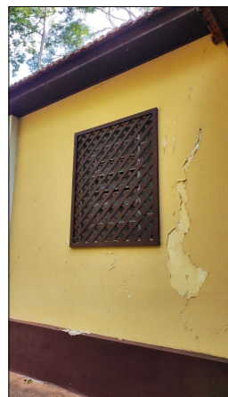
Destacamento de pontos de pinturas externas e desgastes em alguns pontos de elementos de madeira externos.
