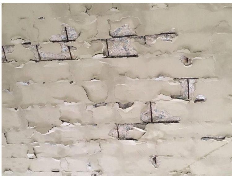
Foto 8: Deterioração do Concreto e oxidação do aço
