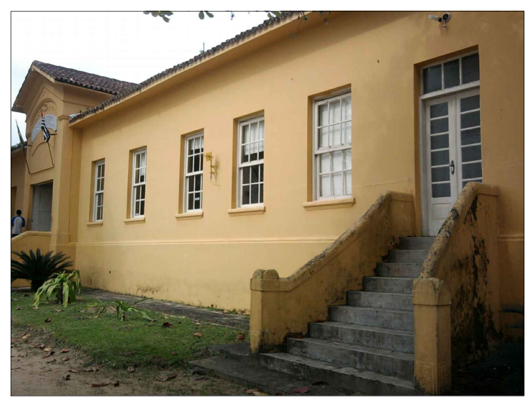
2 LIXAMENTO DAS PAREDES EXTERNAS E DAS ESQUADRIAS, MANTENDO O PADRÃO ORIGINAL DE CÔR.
