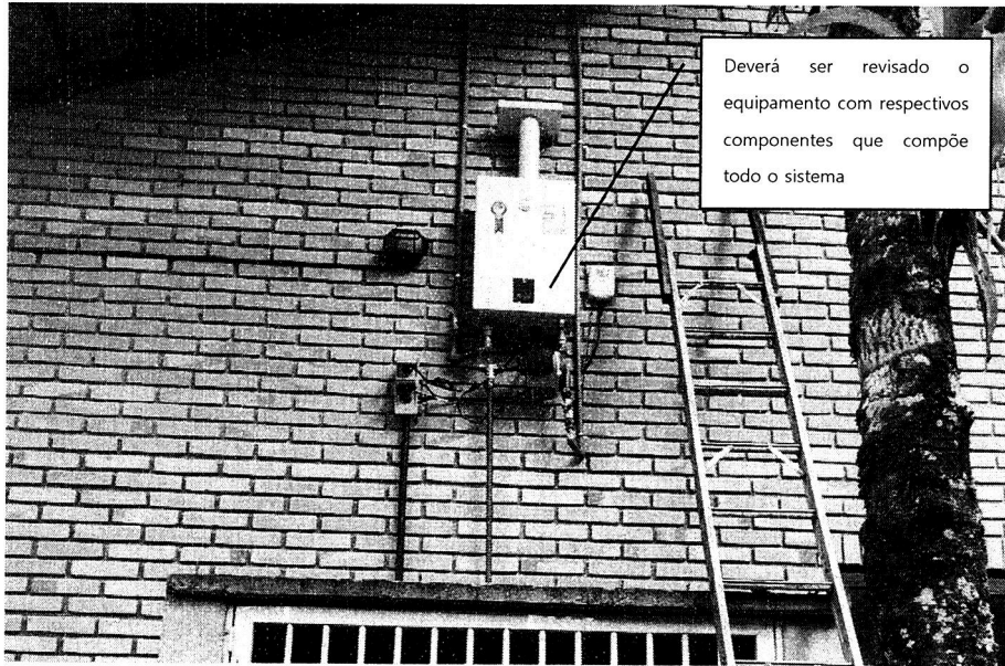
Figura 5: Sistema de aquecimento
