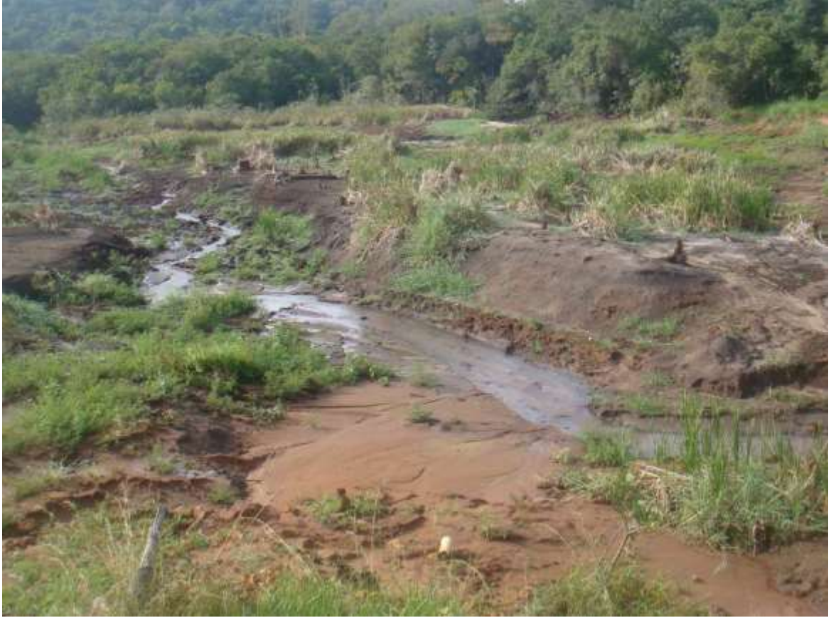
Apêndice 2.3.6.1M. Córrego do Açude (ponto 5), no local onde houve o rompimento da barragem.
