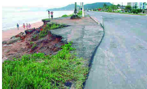
Figura 2.3.2.2.1-1 Erosão na praia de Massaguaçu, Caraguatatuba. Fonte: www.ecolnews.com.br
