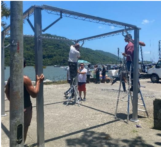
Figura 19 - Instalação PRRM Bertioga.
