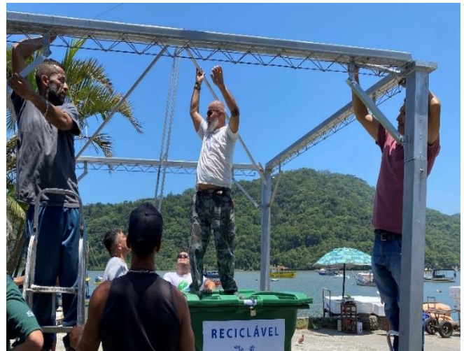
Figura 18 - Instalação PRRM Bertioga.
