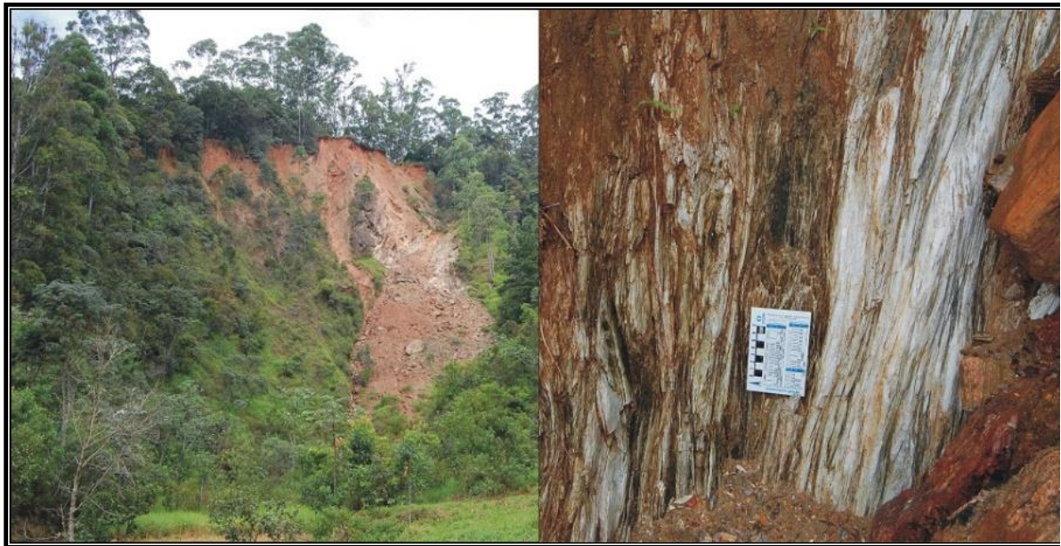
Figura 9.17: À esquerda: área de instabilidade de encosta às margens da rodovia BR-459. À direita: detalhe deste afloramento de talco xisto.
