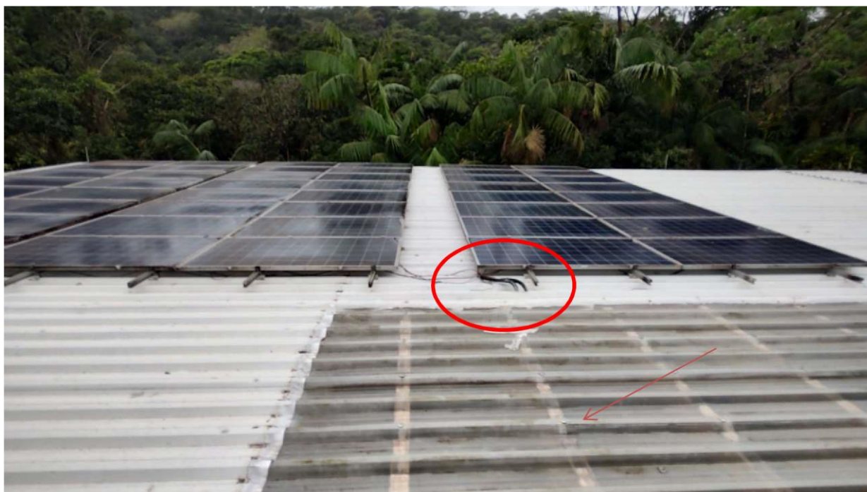
Figura 3 – Eletroduto existente que deverá ser trocado e área de 26,88m 2 de policarbonato transparente que será removido e substituída por novas.
