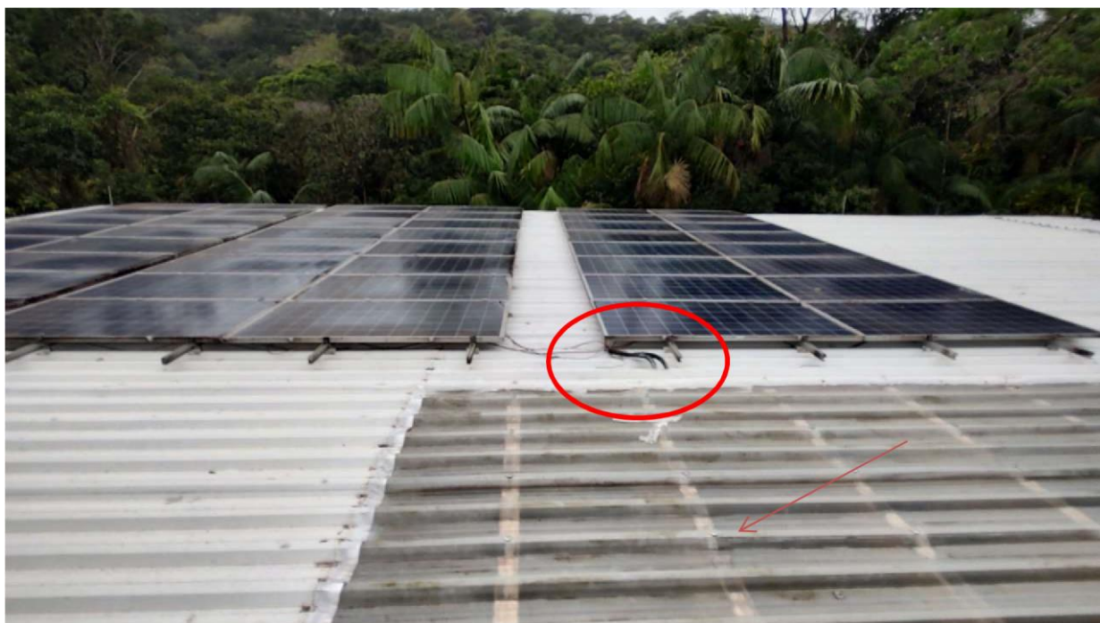
Figura 3 – Eletroduto existente que deverá ser trocado e área de 26,88m 2 de policarbonato transparente que será removido e substituída por novas.
