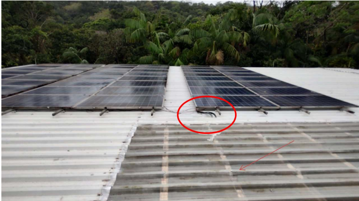
Figura 3 – Eletroduto existente que deverá ser trocado e área de 26,88m 2 de policarbonato transparente que será removido e substituída por novas.
