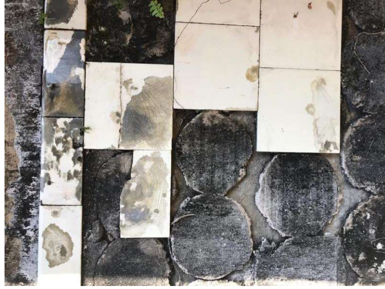
Figura 42 – Ruínas do Presídio Parque Estadual da Ilha Anchieta, 2019. Fonte: Acervo Corsi Arquitetura e Construções LTDA
