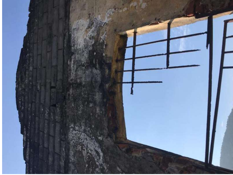
Figura 51 – Ruínas do Presídio Parque Estadual da Ilha Anchieta, 2019.
