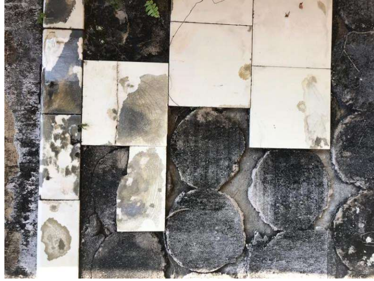
Figura 42 – Ruínas do Presídio Parque Estadual da Ilha Anchieta, 2019. Fonte: Acervo Corsi Arquitetura e Construções LTDA
