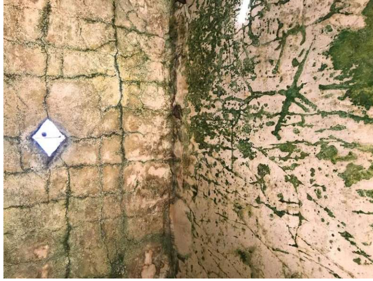
Figura 45 – Ruínas do Presídio Parque Estadual da Ilha Anchieta, 2019. Fonte: Acervo Corsi Arquitetura e Construções LTDA
