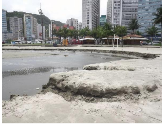
Figura 89 – Erosão nas praias de Santos. Fonte: g1.globo.com
