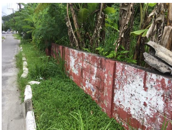
Foto 03 – Muro existente a ser chapiscado como acabamento
