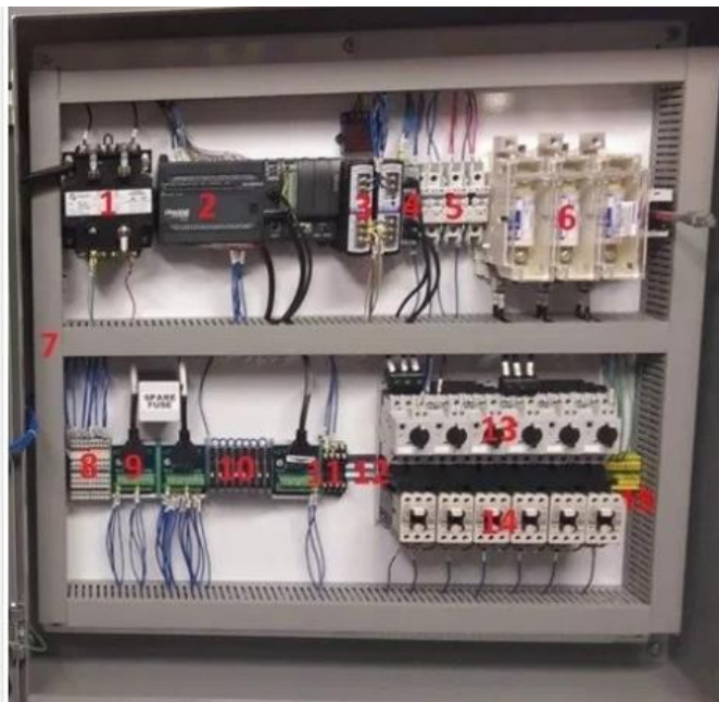
Foto 03 – Vista do quadro elétrico
