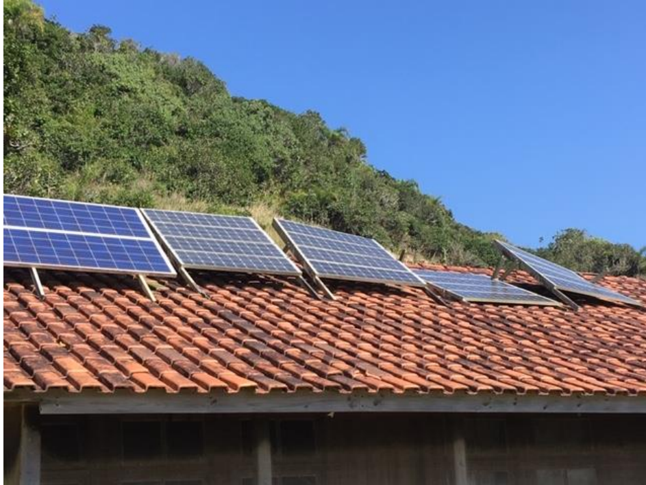
Foto 07 – Vista de painéis fotovoltaicos existentes
