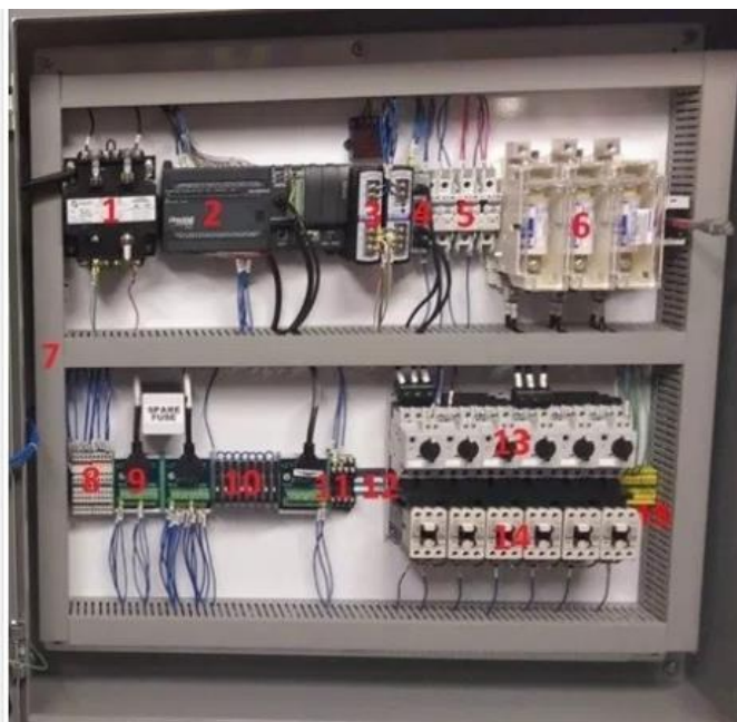
Foto 03 – Vista do quadro elétrico
