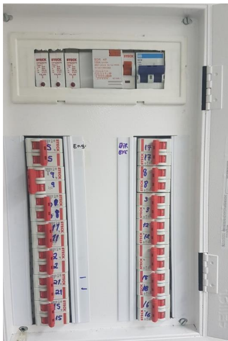
Figura 3 – Quadro de Distribuição (1º Pav)
