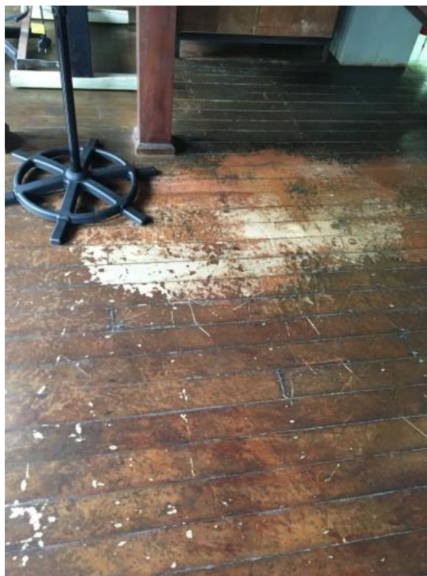
Figura 5 Trecho de piso desgastado.
