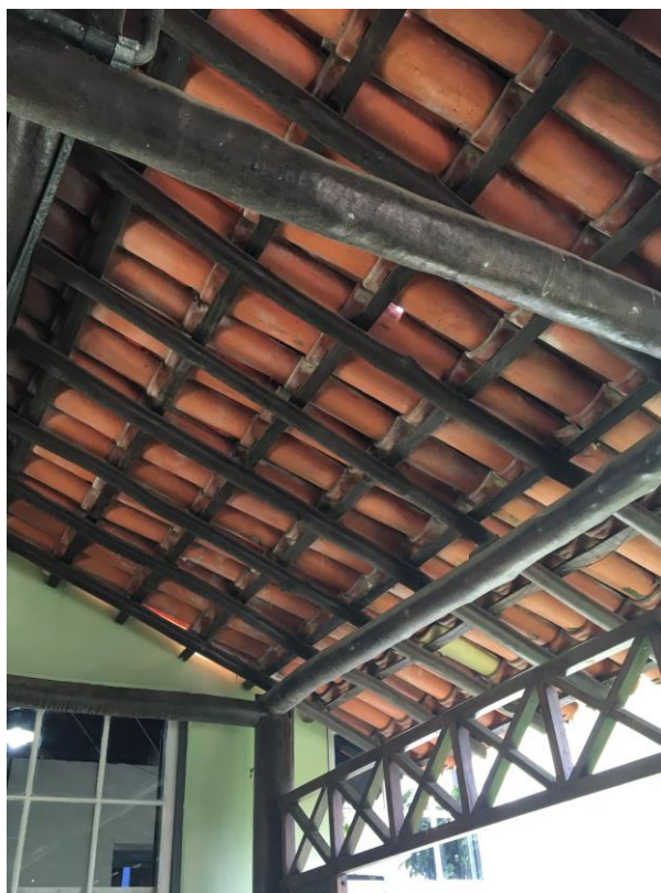
Figura 4 Trecho de cobertura onde há infiltração.
