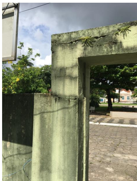
Figura 12 Trecho de muro danificado.
