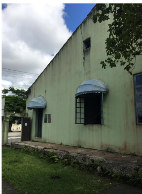
Figura 6 Uma das fachadas externas que necessita de pintura.
