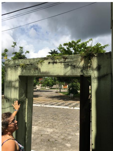
Figura 3 O muro de divisa necessita de reconstrução dos trechos trincados, assim esse material demolido deve ser devidamente retirado.
