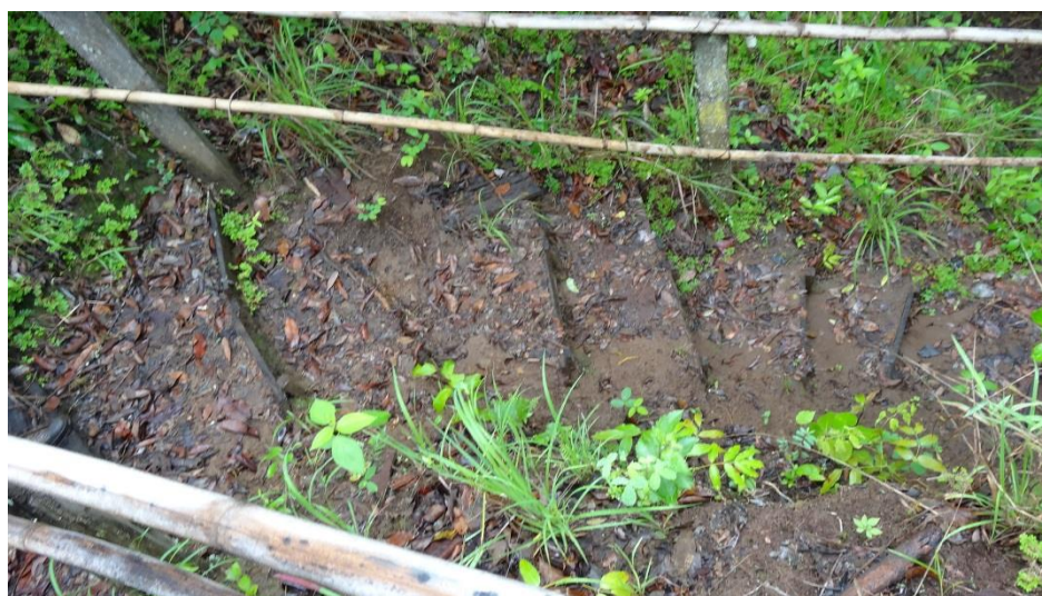
Figura 2 – Necessita de substituição da escadaria
