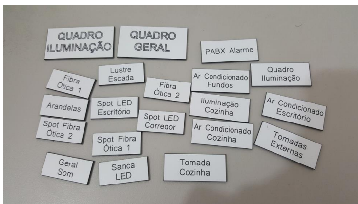
Figura 5 – Plaqueta de identificação de circuitos.
