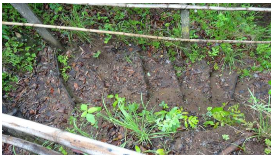
Figura 2 – Necessita de substituição da escadaria
