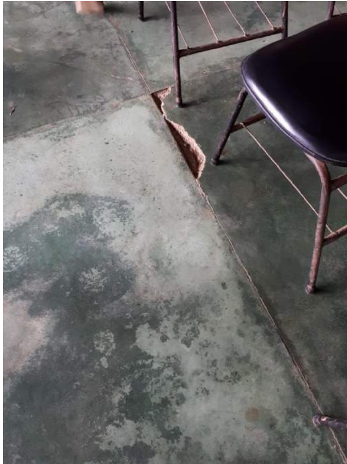
Figura 7 – Foto Piso danificado junto a juntas de dilatação
