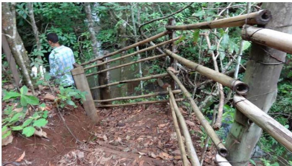
Figura 4 – Início da descida do poço em “S”, guarda-corpo deteriorado.
