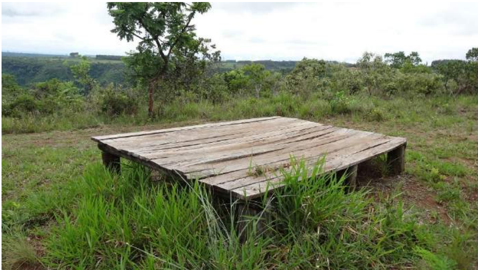
FIGURA 21: DECKS UTILIZADOS COM ELEVADOS DE OBSERVAÇÃO, DETERIORADOS.
