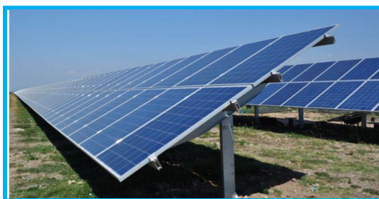
Figura 3 - Exemplo de painel solar fotovoltaico.
