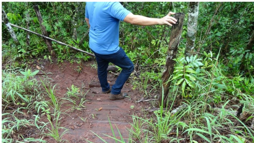
Figura 11: Necessitam de manutenção as escadarias
