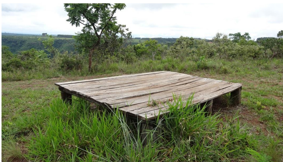
Figura 21: Decks utilizados com elevados de observação, deteriorados.
