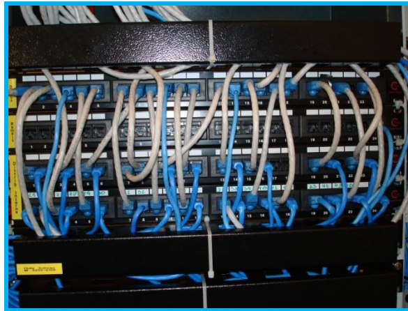
Figura 3 - Exemplo de patch panel interligados por patch cord.
