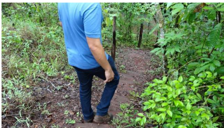
Figura 12: péssimo estado de conservação das escadarias.
