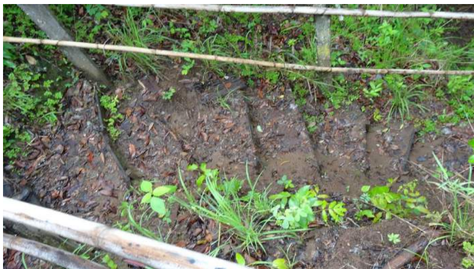
Figura 2 – Necessita de substituição da escadaria
