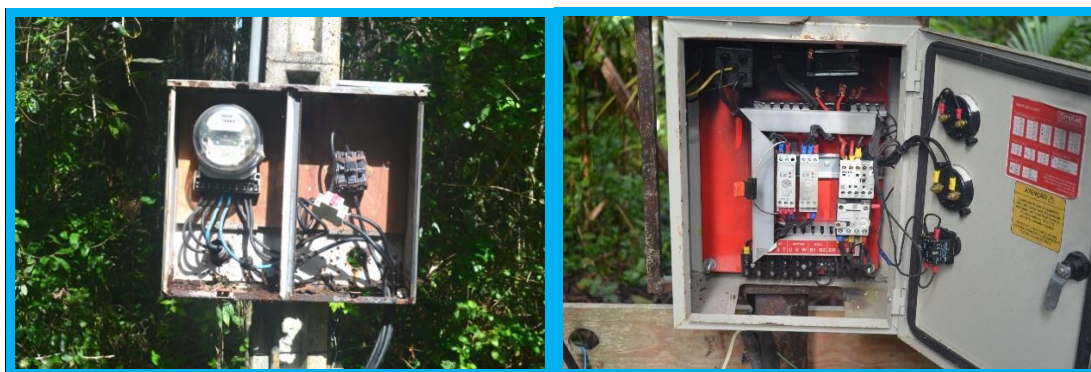
Figura 4 – Padrão de entrada atual e caixa de acionamento da bomba do poço.
