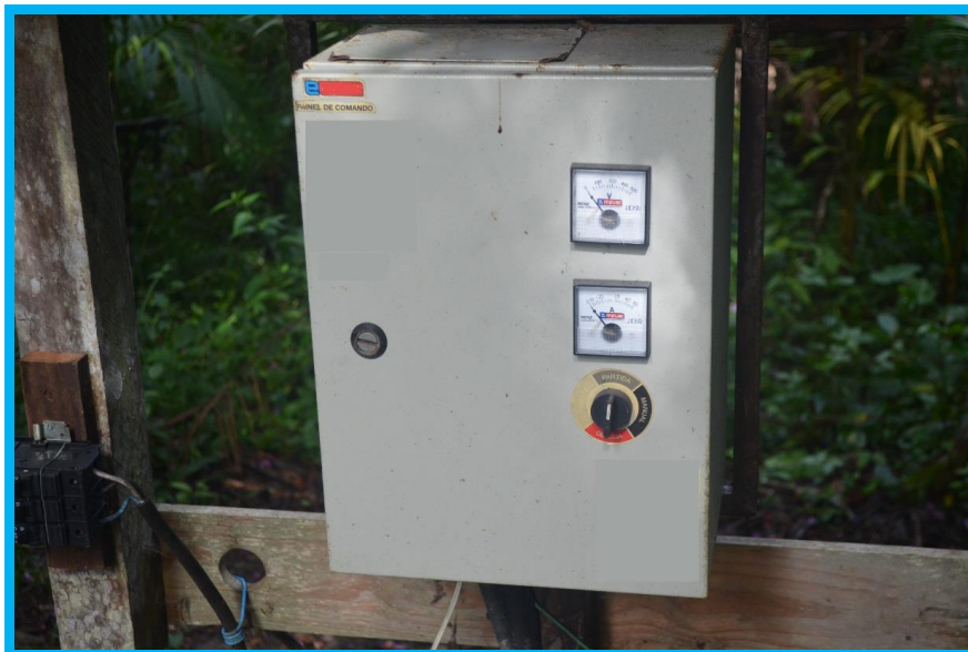
Figura 5 – Caixa de acionamento da bomba existente.
