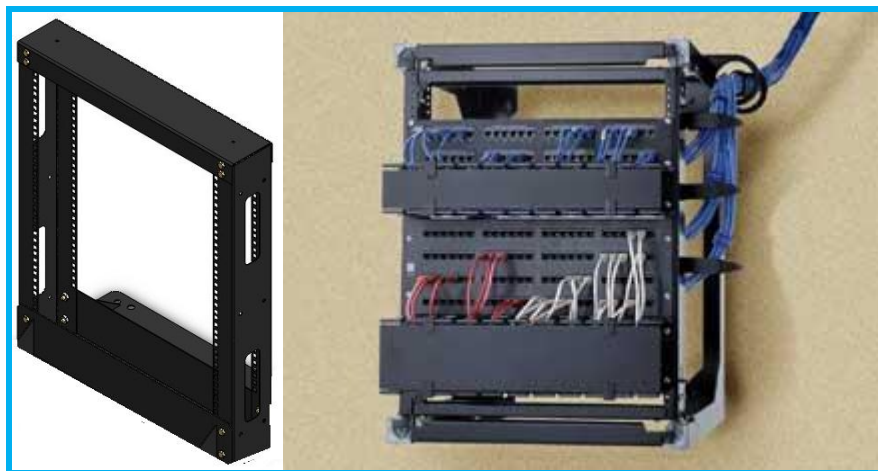
Figura 4 - Rack de parede aberto.
