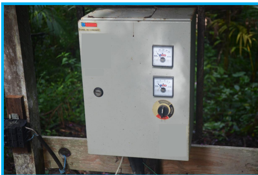
Figura 5 – Caixa de acionamento da bomba existente.
