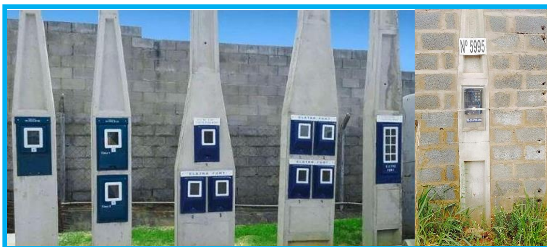
Figura 6 – Padrão de entrada conforme normas da Elektro.
