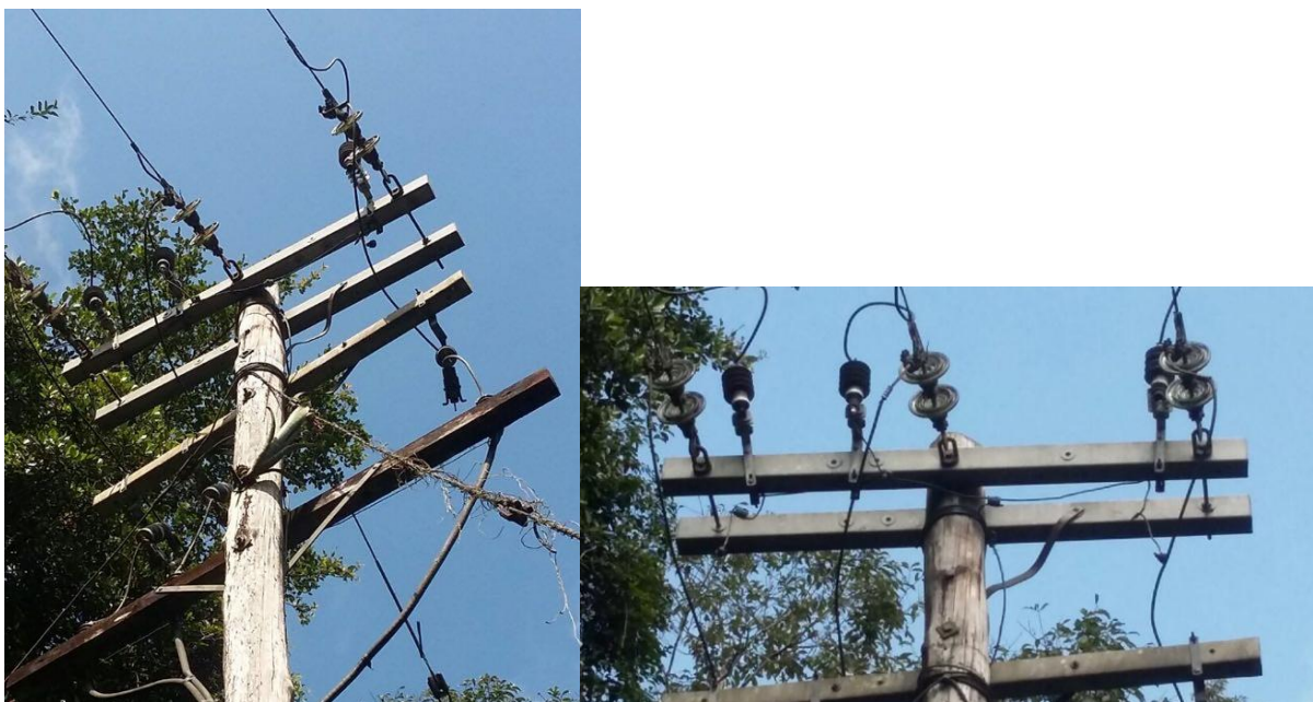
Figura 1 e 2. Postes de energia com os para-raios queimados e elo de fusíveis no Parque Estadual da Caverna do Diabo.
