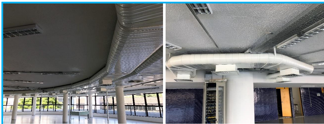
Figura 2 – Dutos do 1° e 4° andar.
