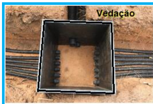
Figura 4 - Exemplo da caixa de passagem com tampa vedada.
