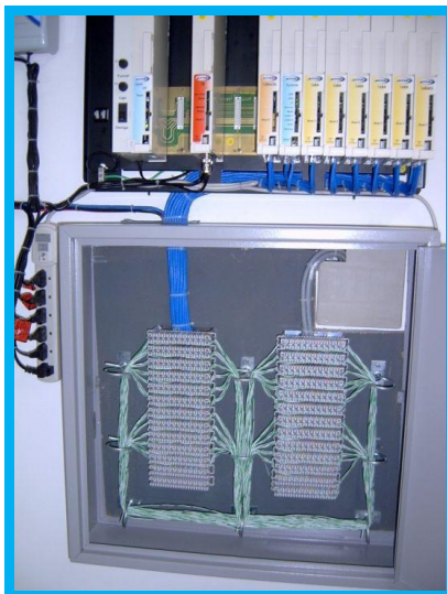
Figura 9 - Exemplo de central telefônica e cabeamento em parede.
