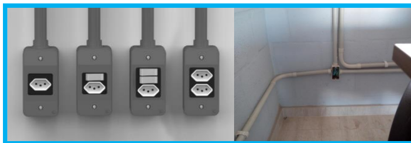
Figura 3 - Condulete com eletrodutos aparente.
