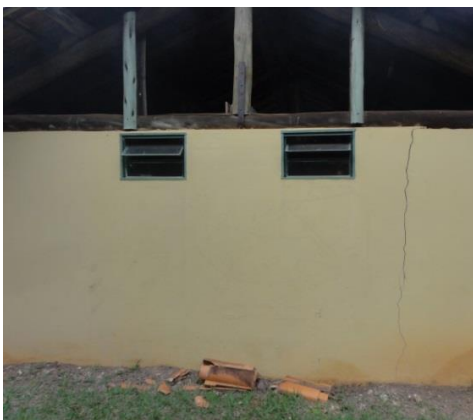
Detalhe da trinca
