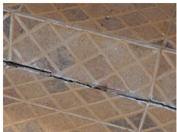
Refazer o rejunte de todo o piso
