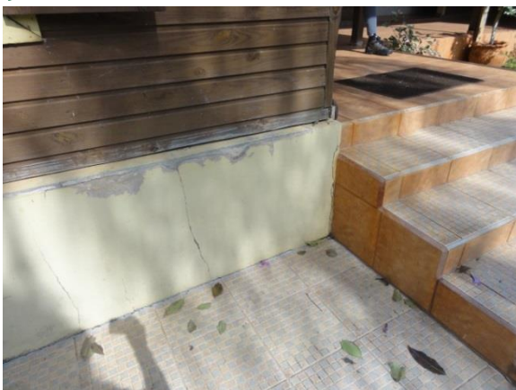
Rachaduras na base
