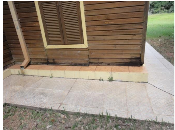
Excesso de umidade
