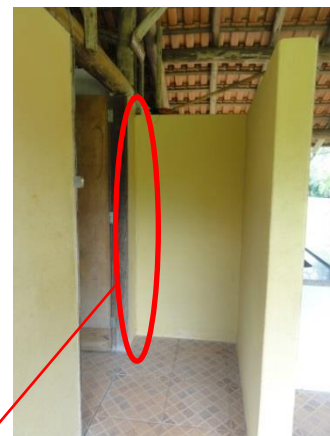
Trinca de em toda parede SM
