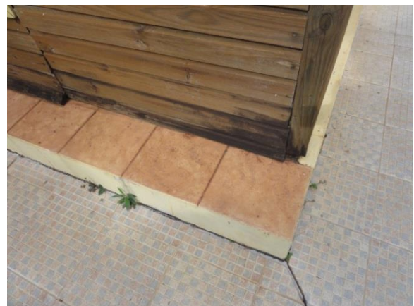
Umidade excessiva na parede
