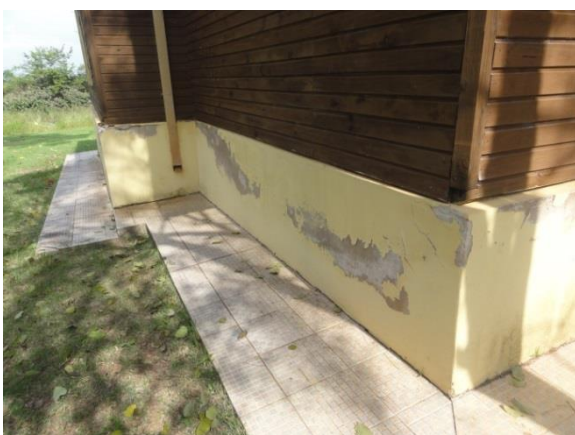
Base precisando de manutenção
