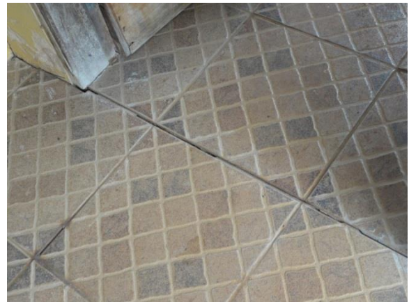
Refazer o rejunte
