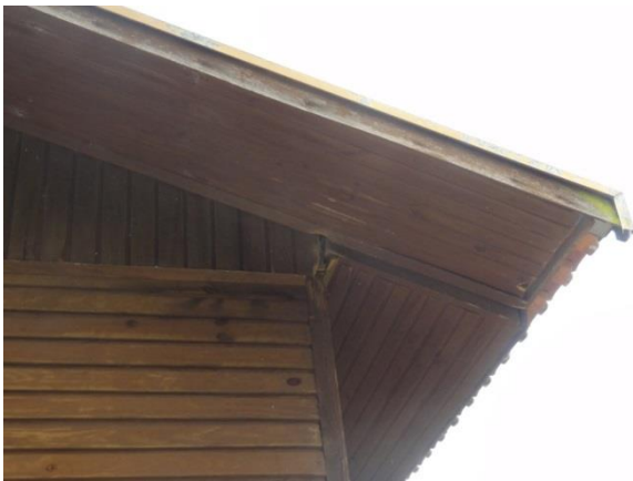
Forro e calha danificadas
