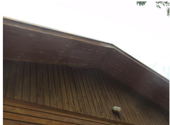
Forro e calha danificadas
