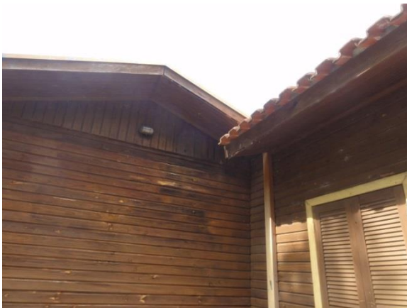
Paredes com excesso de umidade
