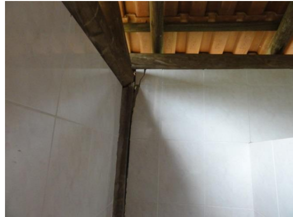
Trinca do banheiro do canto
