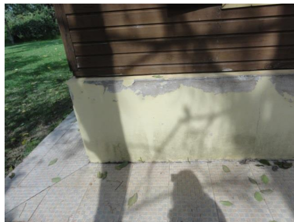
Falta pintura na base
