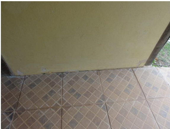
Refazer o rejunte
