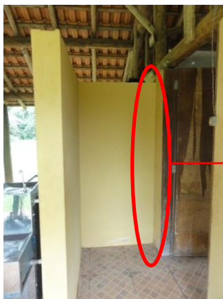
Trinca de em toda parede
