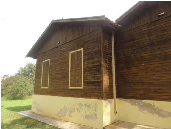
Paredes com umidade
