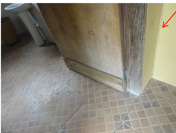
Detalhe da trinca SM
