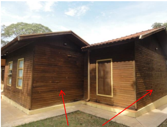
Paredes com excesso de umidade
