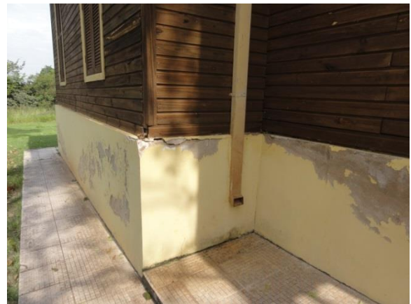
Base com trincas
