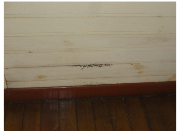
Fungos de morcego nas paredes
