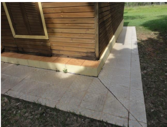
Calçada precisando de rejunte
