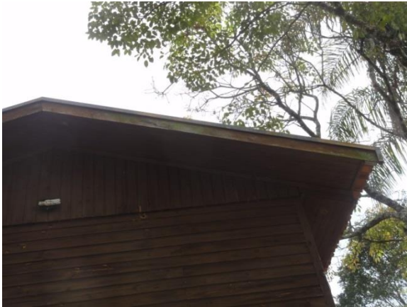
Detalhe da parede com umidade
