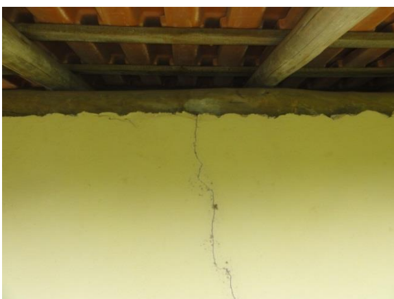
Tela Selatrinca em parede
