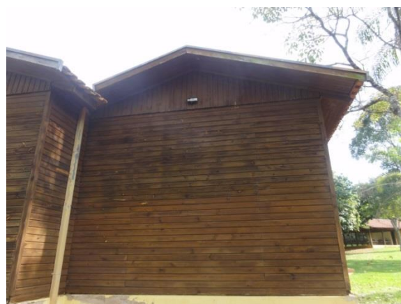
Parede de madeira com umidade
