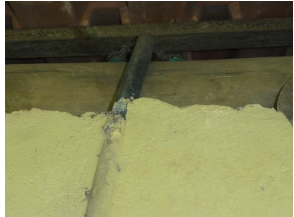
Detalhe da Elétrica
